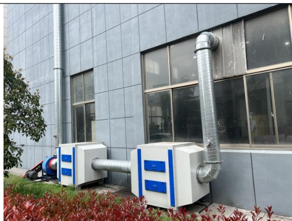
发泡废气处理设施
