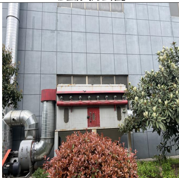
焊接废气处理设施
